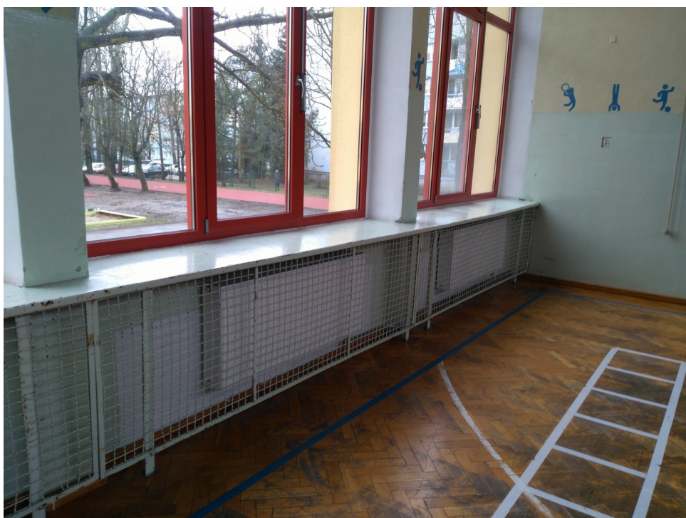
Zdj. 4: Stalowe osłony grzejników
